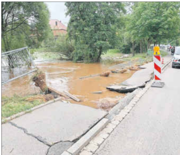
Eine unterspülte Straße in Wilhermsdorf
